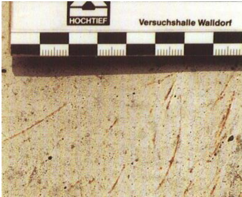
Bild 26: Rostende Fasern führen nicht zu Abplatzungen an der Oberfläche [Lit 12]
