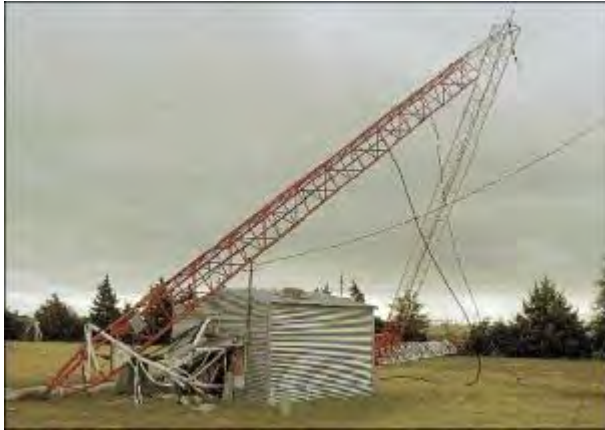
Bild 113: Windgeschwindigkeiten in Böen bis 190 km/h brachten diesen 127,7 m hohen Sendemast in den USA zum Einsturz
