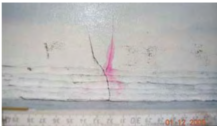
Bild 98: Verdeckter Verzinkungsriss (MT-geprüft) neben einem klaffenden Riss im Steg eines Trägers mit eingeschweißter Anschlusslasche sowie Längsrissanzeigen im Schweißgut [Lit 36]
