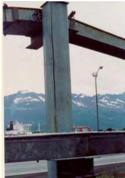
Bild 110: Längsriss durch den Sprengdruck des in der Stütze gefrierenden Wasser [Lit 78]
