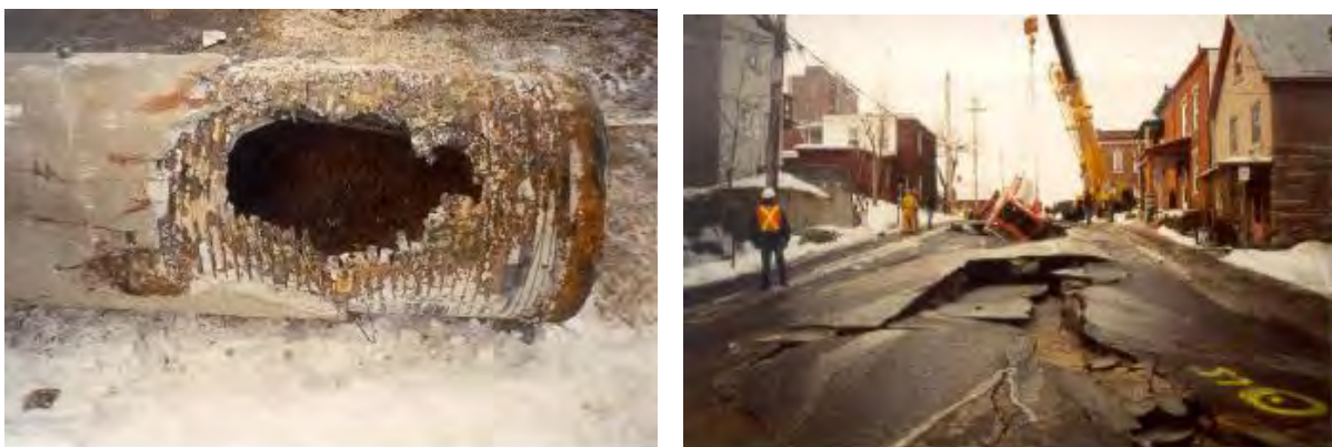
Bild 86: Bewehrungskorrosion durch aggressiven Boden (links) und resultierende Folgen (rechts) [Lit 52]
