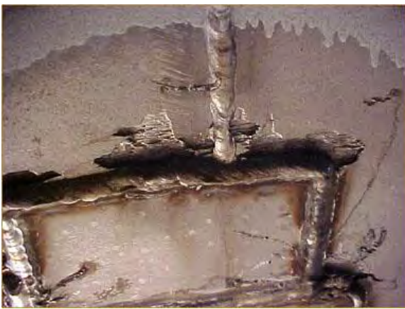
Bild 70: Chloridinduzierte Korrosion in der Wärmeinflusszone einer Schweißnaht [Lit 104]
