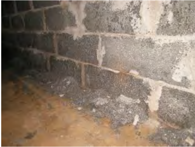
Bild 124: Zerstörte Mauersteine im Sockelbereich eines Gebäudes durch sulfathaltige leichte Gesteinskörnung
