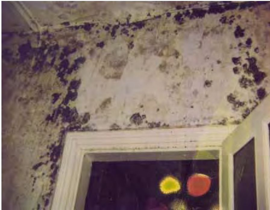
Bild 7: Auswirkung eines Wasserrohrschadens für die durchnässten Innenwände [Lit 79]
