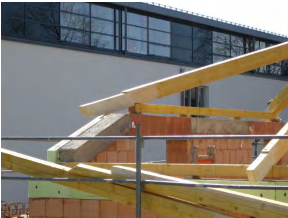
Bild 58: Fehlerhafte Ausführung eines Ringankers
