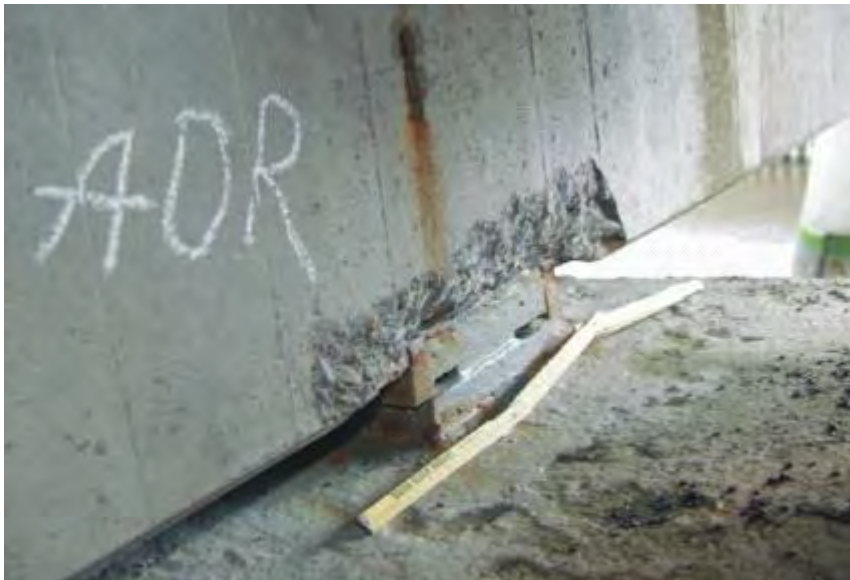
Bild 14: Querschnittschwächung durch das Abplatzen der Betondeckung eines mehrstegigen Plattenbalkens oberhalb eines Lagers am Oste-Sperrwerk [Lit 102]
