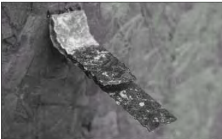
Bild 10: Korrodiertes Mauerwerksanker [Lit 61]
