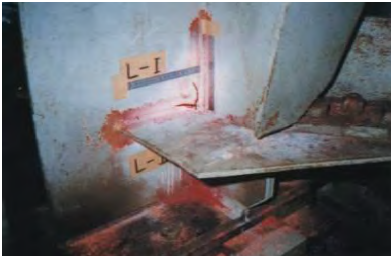
Bild 95: Riss entlang der Schweißnaht an der Verbindung zwischen Anschlussplatte und der Vertikalaussteifung
