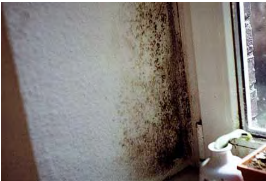
Bild 59: Schimmelpilz in einer Fensterlaibung [Lit 43]
