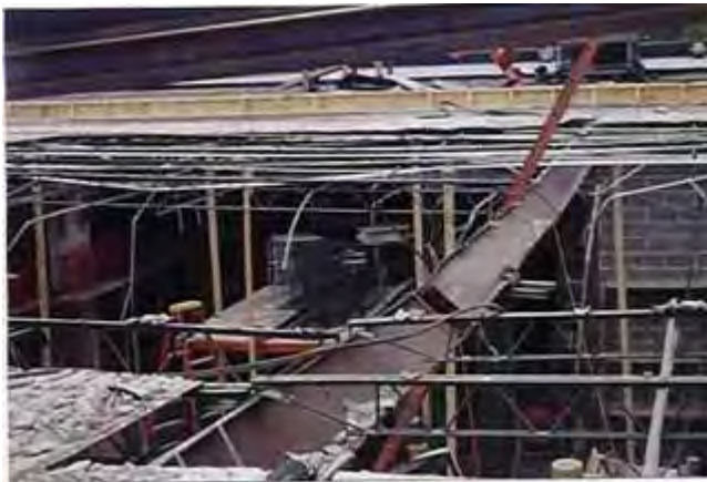
Bild 89: Eingestürztes Dach eines Einkaufszentrums verursacht durch das Beulen eines Querträgers [Lit 10]
