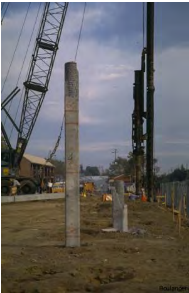
Bild 138: Durch übermäßige Schlagbelastung zerstörte Pfahlköpfe [Lit 6]
