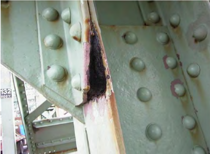
Bild 72: Spaltkorrosion am genieteten Träger einer Brücke
