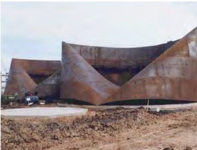
Bild 90: Während des Baus durch Wind zerstörte Öllagertanks
