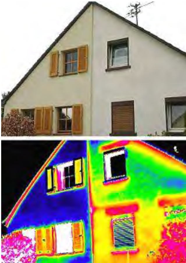
Bild 55: Einsatz der Thermografie. Die sanierte Haushälfte (links) mit modernen Wärmeschutzfenstern und von außen gedämmter Fassade verliert deutlich weniger Energie als die nicht sanierte Hälfte (rechts) [Lit 76]
