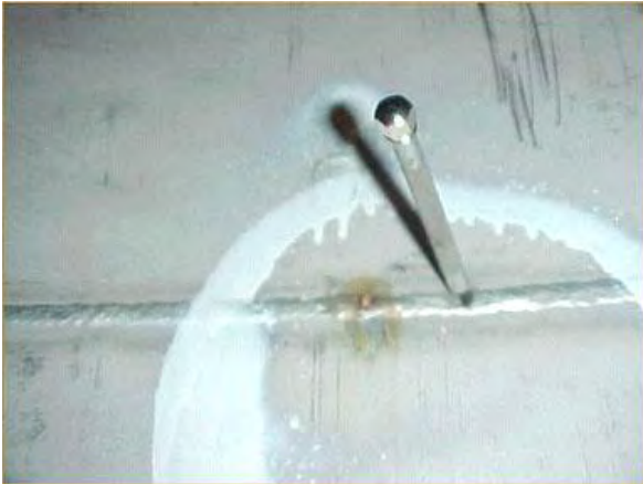
Bild 69: Chloridinduziertes Korrosionsloch in der Schweißnaht eines Tanks aus rostfreiem Stahl. Der Dorn wurde zur Veranschaulichung hineingesteckt [Lit 104].
