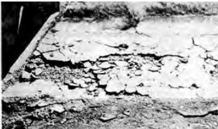
Bild 123: Netzrisse und Abplatzungen als Folge eines Sulfatschadens [Lit 35]
