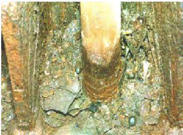
Bild 82: Es genügt schon, wenn ein Mastbereich nicht vom Wind erfasst und getrocknet wird, wie der Fuß eines WT-Mastes, um den nur 60 cm Platz war [Lit 44]
