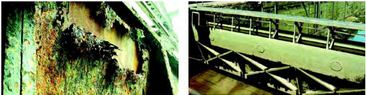
Bild 4: Beispiel für den Zustand von Schleusentoren zum Zeitpunkt t_A nach Bild 3 links ohne Instandhaltung bzw. rechts mit Instandhaltung [Lit 62]
