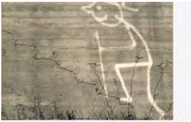
Bild 131: Kreative Lösung zum Kaschieren unzureichend verbundener Betonierlagen
