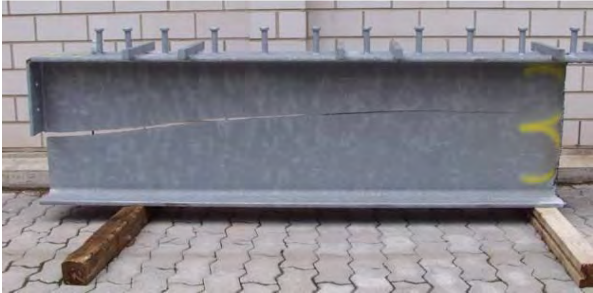
Bild 97: Riss im Steg eines verzinkten Deckenträgers mit halber Kopfplatte [Lit 45]
