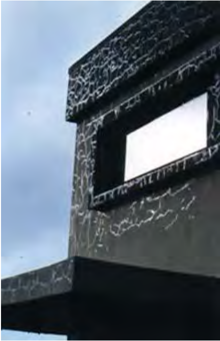
Bild 126: Durch ASR geschädigte Wand [Lit 74]
