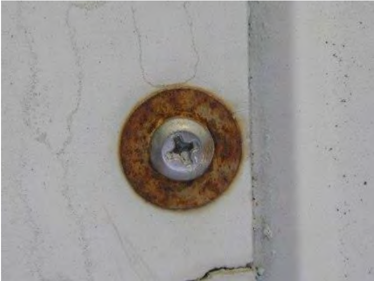
Bild 74: Durch Kontaktkorrosion mit einer Edelstahlschraube angegriffene Cadmiumbeschichtete Unterlegscheibe
