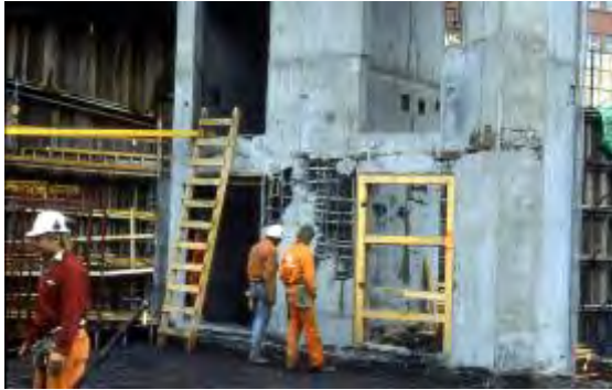
Bild 132: Große Fehlstellen nach dem Betonieren einer hohen filigranen Wand
