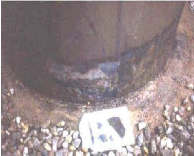
Bild 81: Korrosionsschaden an einem Mastfußpunkt aus WT-Stahl. Auf Wunsch des Architekten war ca. 30 cm Kies angefüllt worden [Lit 44]
