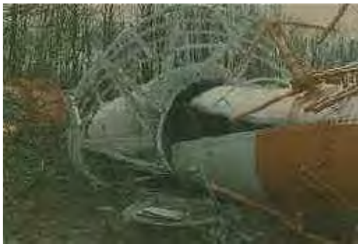
Bild 112: Masteinsturz u. a. wegen Wirbelerregung [Lit 44]
