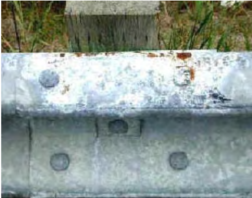
Bild 84: Korrodierte Verzinkung einer Leitplanke
