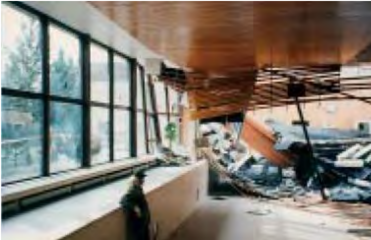
Bild 11: Eingestürztes Turnhallendach infolge einer Verdrehung am Auflager [Lit 101]
