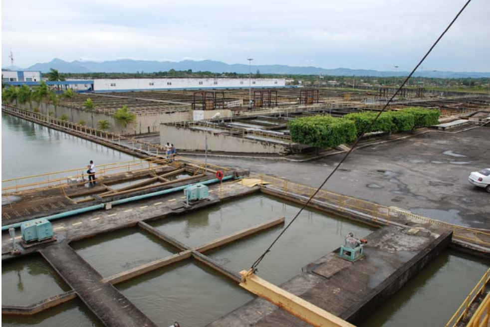
Bild 27: Wasseraufbereitungsanlage von Guandu
