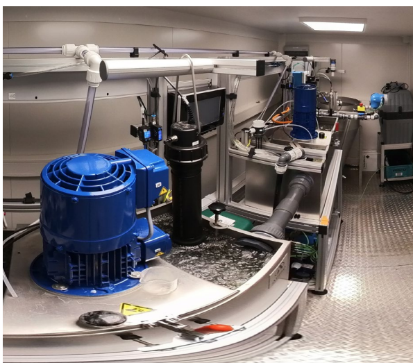
Abb. 1: Becken für die biologische Behandlung in der Versuchskläranlage
