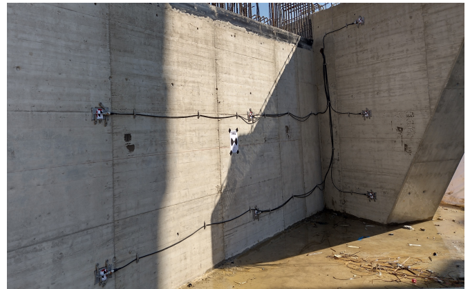
Erddrucksensoren an der Widerlagerrückwand mit Messmarken
