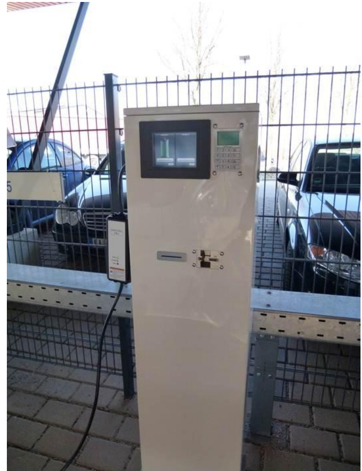
Pilotprojekt Stromparkplätze www.stropa.de
